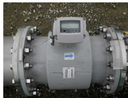
可搬型第1貯水槽給水流量計
