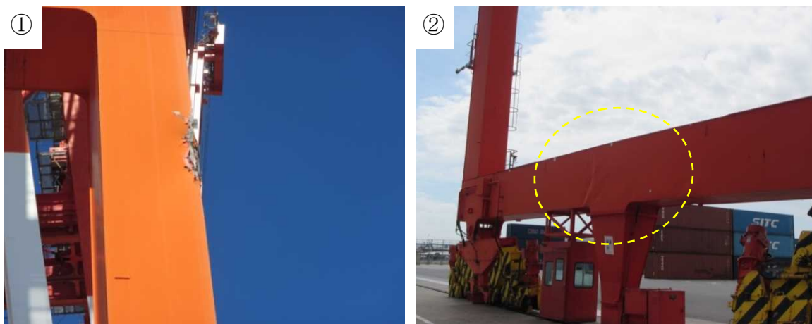
北東角脚部 (衝突痕)
