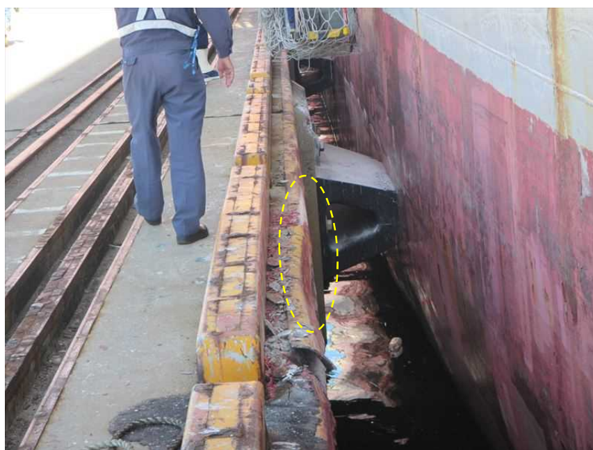
図7 本件岸壁の損傷状況
