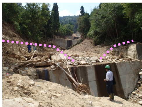
東広島市黒瀬治山ダムの袖部被災状況
